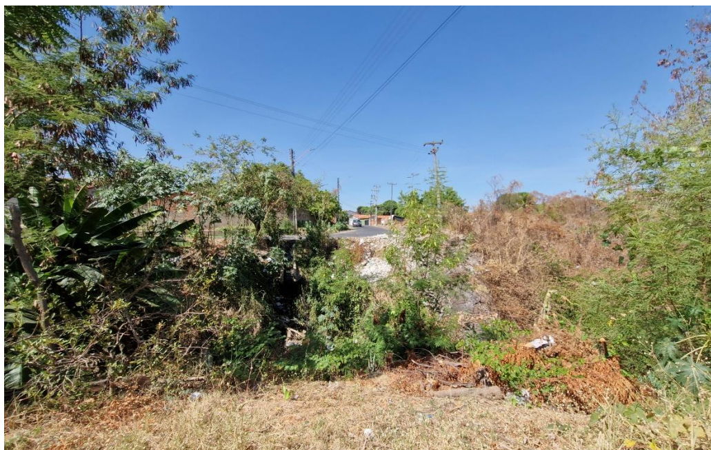
Figura 41 - Trecho com necessidade de intervenção para melhoria da drenagem urbana na Área Verde 02 do Residencial Betinho
