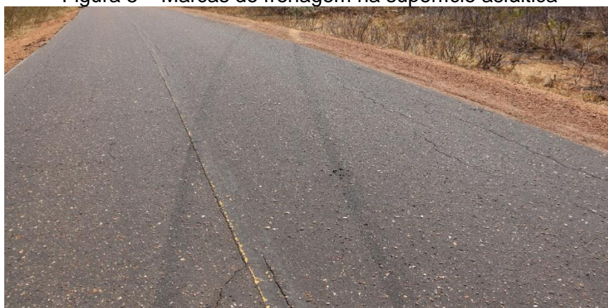
Figura 5 – Marcas de frenagem na superfície asfáltica
