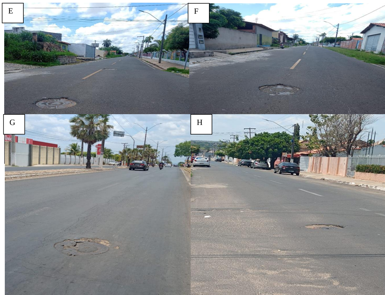
Figura 2 – Rede de Esgoto de Floriano-PI. E – Rua: Marques da Rocha; F – Trecho da Avenida Bucar Neto; G – Trecho da Avenida Calisto Lobo; H – Rua: Fernando Marques.
