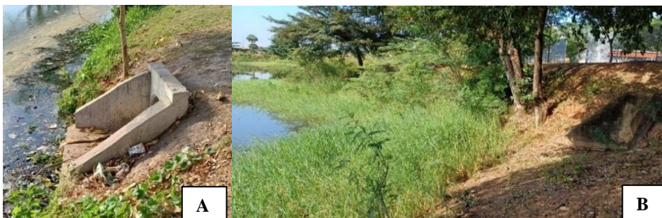
Figura 25. Aberturas de esgoto nas lagoas do Parque Lagoas do Norte. Na imagem A abertura de esgoto observada na lagoa do Matadouro. No registro B, imagem na lagoa do São Joaquim.
