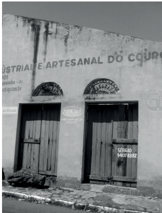
Figura 10 - Fachada de edificação, prédio público - Porto das Barcas, Parnaíba Fonte: Acervo da autora, 2015.
