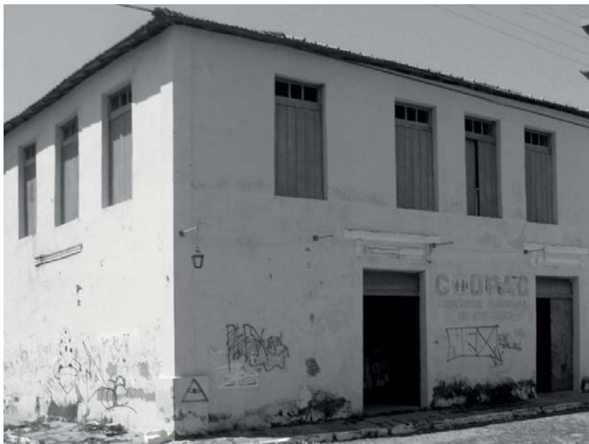
Figura 12- Fachada de prédio público | Porto das Barcas, Parnaíba Fonte: Acervo da autora, 2015.
