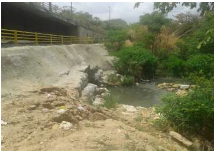
Fotografia 3 – Ponto de lançamento de esgoto no Rio Parnaíba
