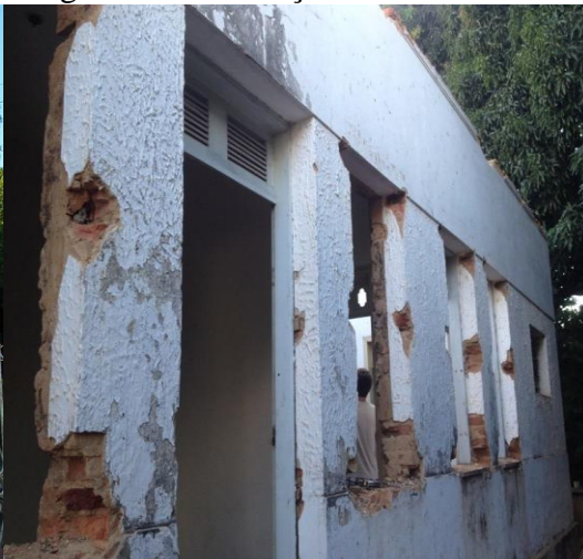
Figura 2 – Destruição do imóvel
