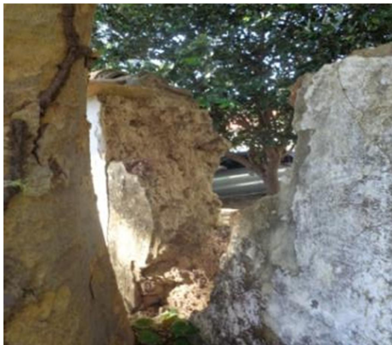
Figura10 – Muro de pedra de jacaré parcialmente destruído
