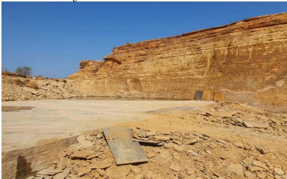
Figura 8 – Taludes não suavizados
