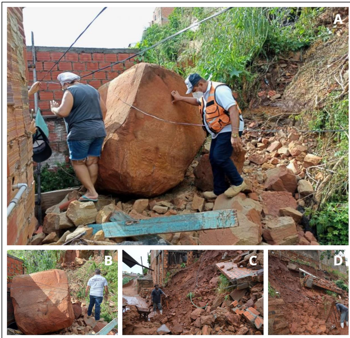
Figura 33 - Deslizamento de terra com rolamento de blocos em residências no bairro Paroquial em Picos-PI
