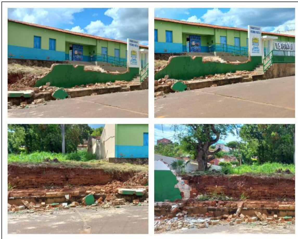
Figura 26 - Condição da fachada da Unidade Escolar Petrônio Portela, no Bairro São José, após uma forte chuva
