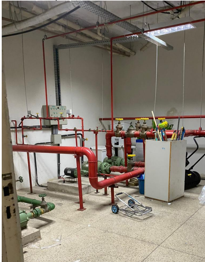
Figura 33 - Casa de Bombas na circulação das Audiências de Custódia
