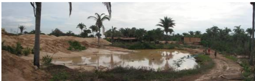
Figura 44 – Sistema de lavagem do massará na franja urbana de Teresina, nas proximidades do bairro Aroeiras.
