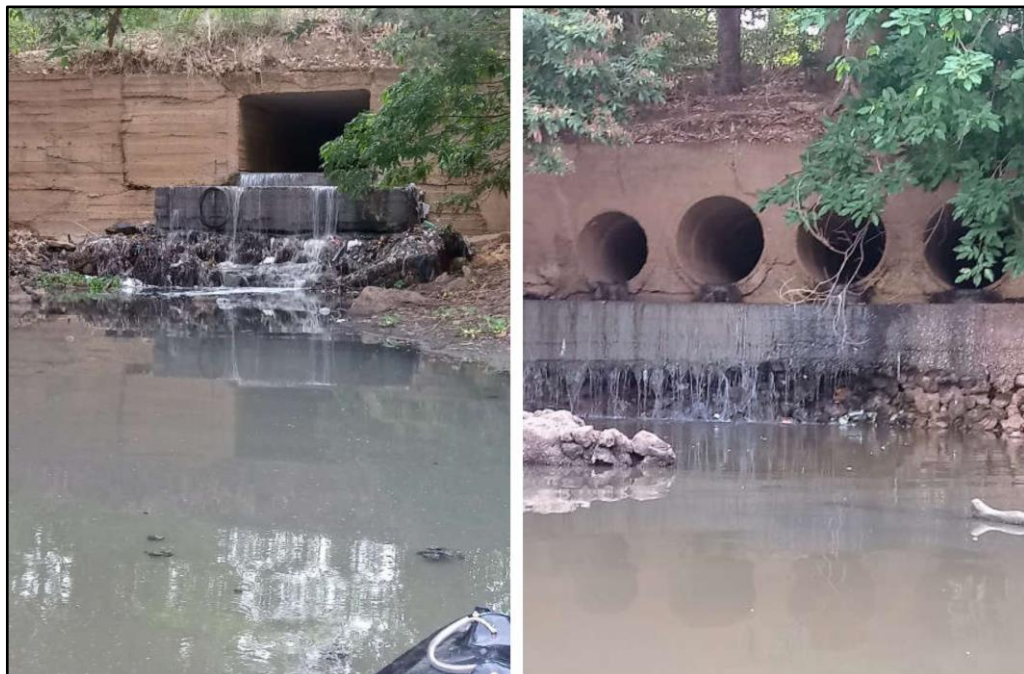
Figura 24: Lançamento de esgoto na rede de drenagem no rio Poti entre os pontos P-4 e P-5.
