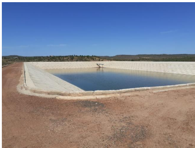
Figura 41 - Lagoa de Estabilização de Esgoto
