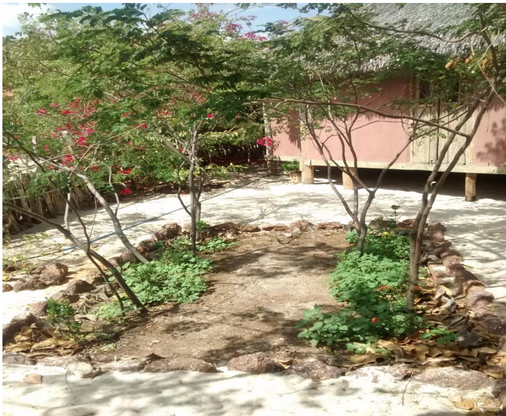
Figura 24 - Fotografia de fossa ecológica em pousada na Comunidade de Barra Grande - Cajueiro da Praia/PI
