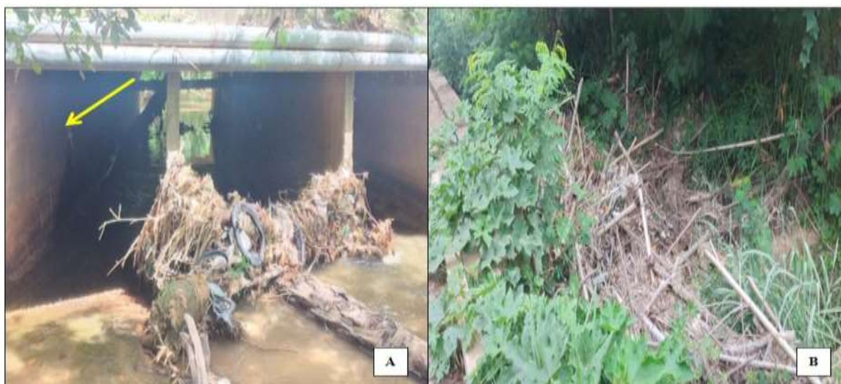
Figura 11 - Presença de resíduos e ligações clandestinas de esgotamento sanitário no P4. A: Resíduos acumulados dentro do corpo hídrico e identificação de ligações clandestinas de despejo de efluentes. B: Acumulo de resíduos as margens do corpo hídrico.
