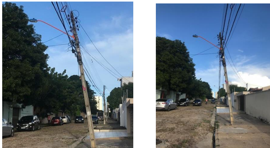
Figura 2 – Postes com deformidades
