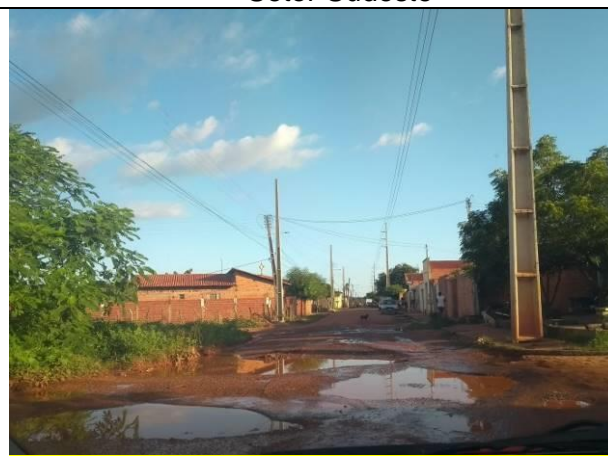
Figura 61 - Ruas sem pavimentação e equipamentos de drenagem urbana – Setor Sudeste
