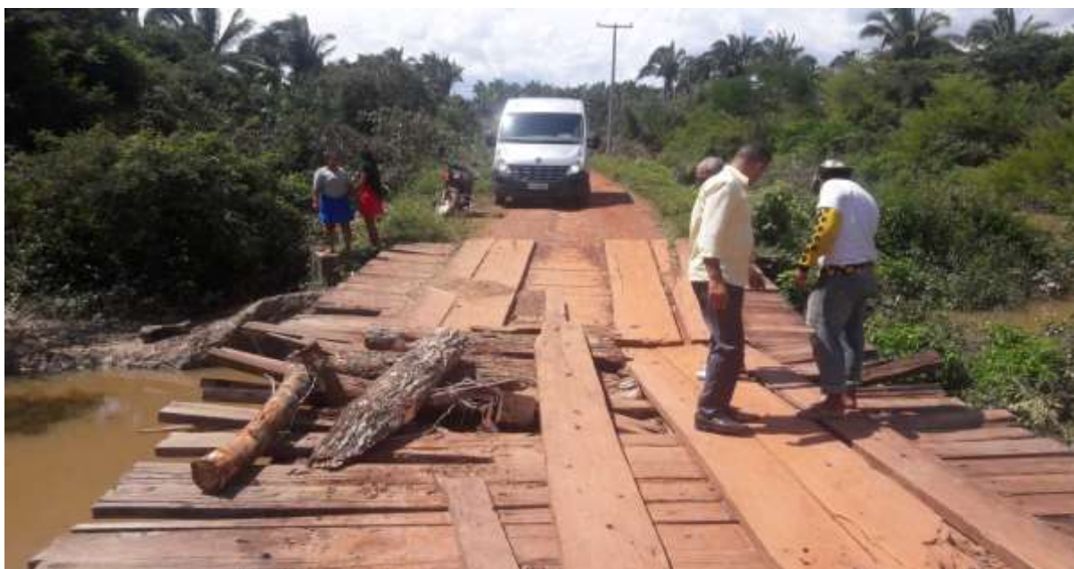
Fotografia 14: Ponte sobre o Riacho Paulica na estrada que liga a Comunidade Piqui da Rampa à sede do Município de Vargem Grande – MA.
