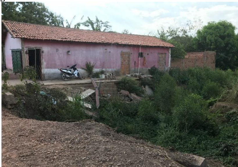
Figura 10.13: Moradia com risco de desabamento na vila Irmã Dulce
