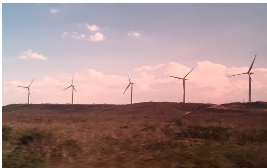
Figura 21 - Parque Eólico Instalado entre os municípios de Tianguá e Ubajara na Serra da Ibiapaba no Ceará
