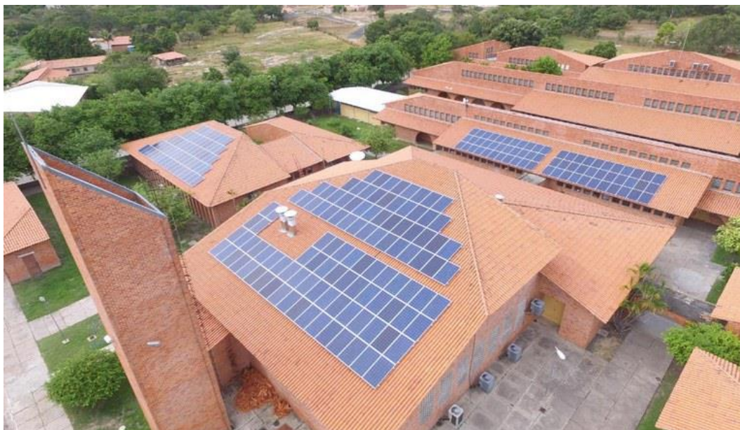
Figura 2 – Vista parcial do Sistema fotovoltaico instalado no campus Floriano do IFPI.
