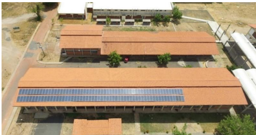
Figura 10 – SFCR instalado no Bloco 8 do Centro de Tecnologia da UFPI.
