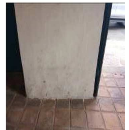
FIGURA 50 – Infiltrações e umidade nas paredes do Primeiro Pavimento. Fonte: Arquivo Arquiteta Ellaine Martins, 2017.
