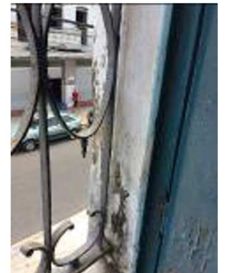
FIGURA 59- Patologias externas: desgaste de pintura, infiltrações e umidade. Fonte: Arquivo Arquiteta Ellaine Martins, 2017.
