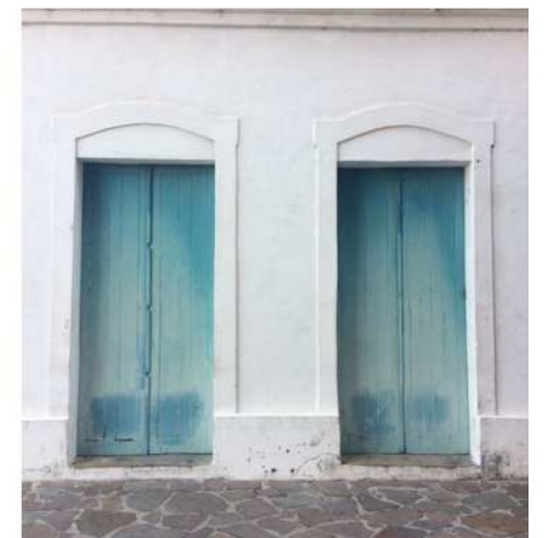
FIGURA 53- Umidade em paredes externas e desgaste na pintura de esquadrias. Fonte: Arquivo Arquiteta Ellaine Martins, 2017.
