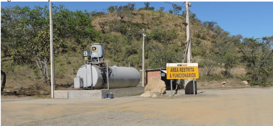
Figura 4 – Tanque de combustível
