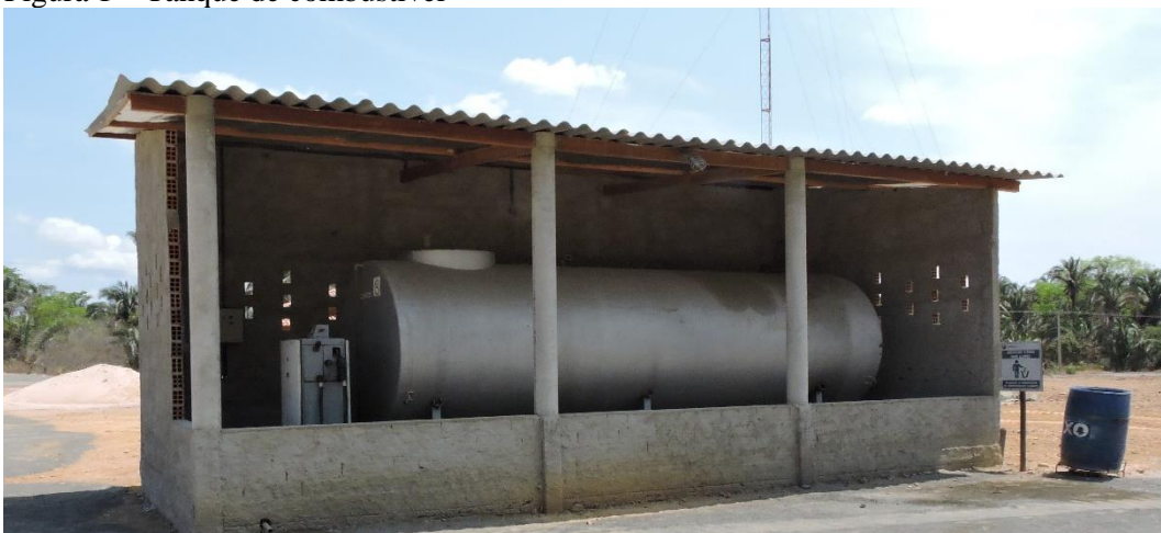
Figura 1 – Tanque de combustível
