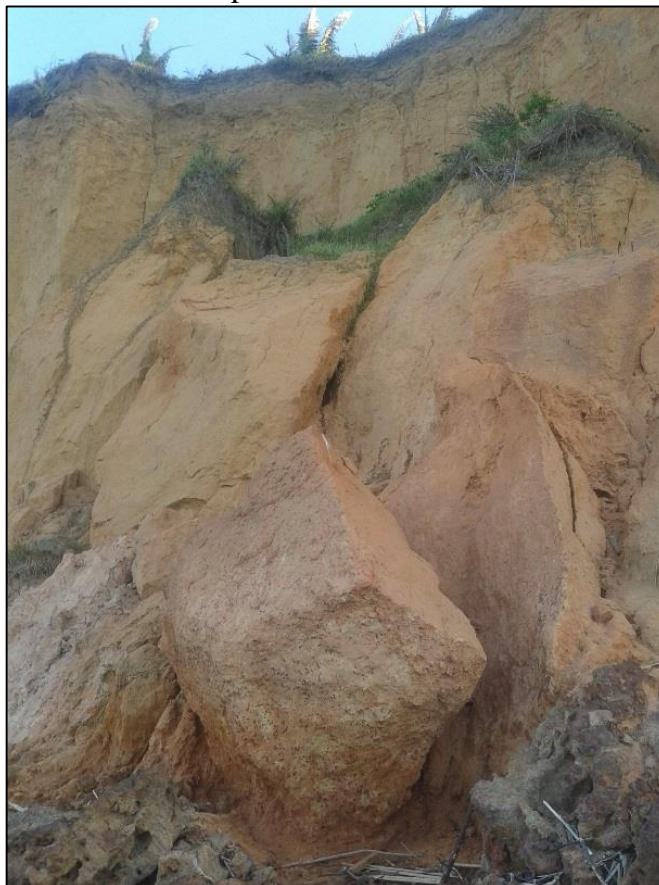
Figura 63 – Fotografia da queda de blocos na falésia de Itapari
