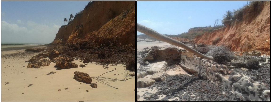
Figura 50 – Fotografias de muros parcialmente tombados
