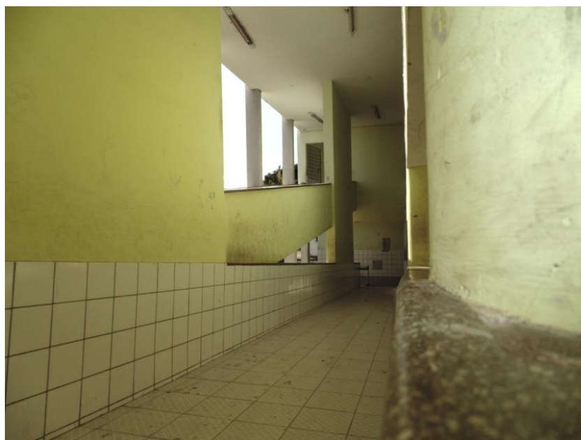
Figura 83: ILUMINAÇÃO NA RAMPA
