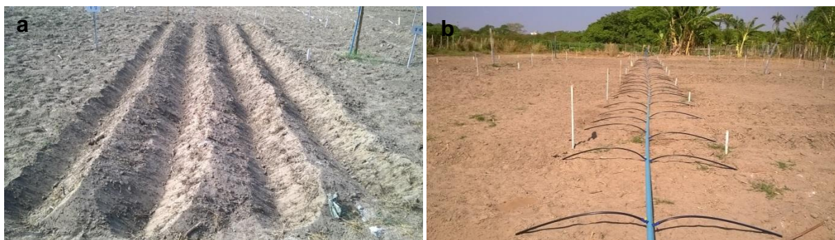
Figura 3 – Abertura dos sulcos para instalação do sistema de irrigação por gotejamento subsuperficial (a). Implantação do sistema de irrigação (b).
