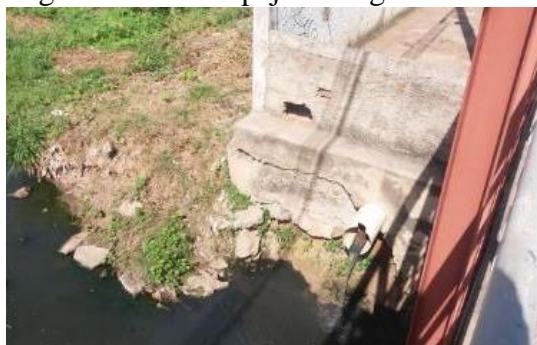
Figura 8.18 – Despejo de esgoto no canal
