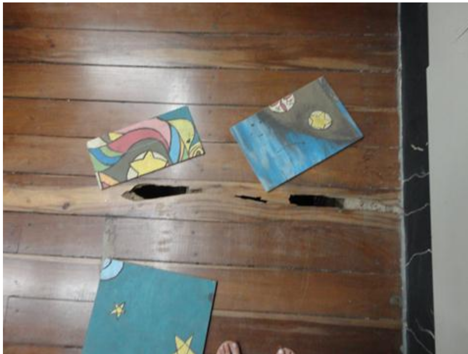
Foto 12 – Piso danificado. Os quadros são colocados encobrir os buracos. Fonte: arquivo pessoal.
