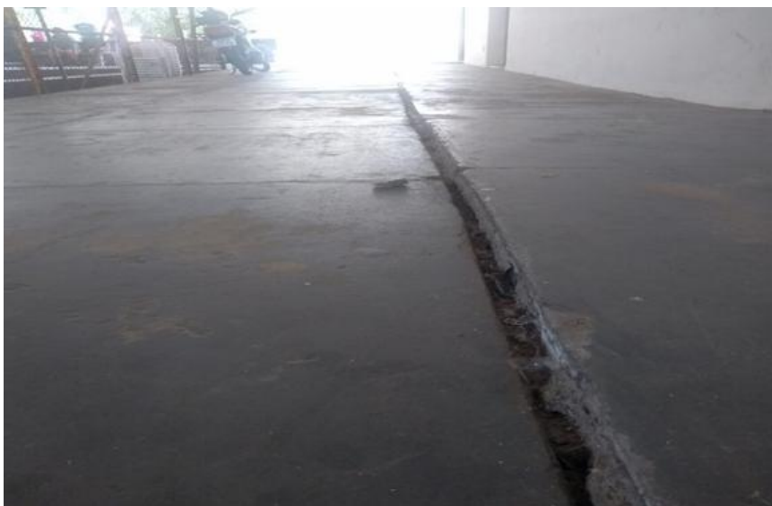
Figura 2 – Piso irregular em ambiente interno do Setor de Esportes
