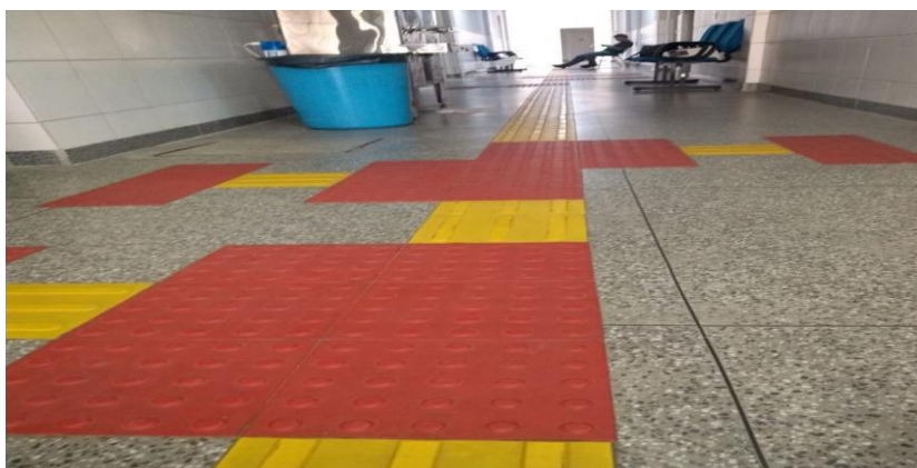
Figura 20 – Piso tátil direcional e de alerta nas dependências internas do prédio de Libras
