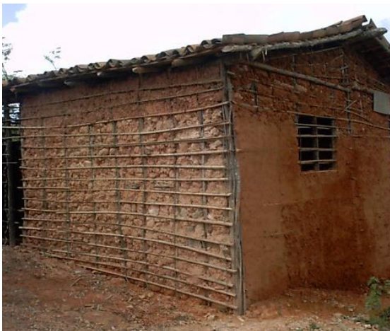
Figura 109. Exemplo de construção em taipa de mão, mal executada.
