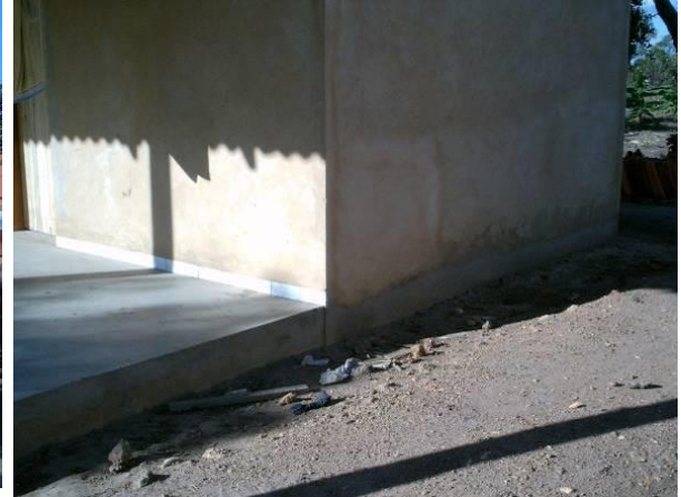
Figura 51. Vista da fundação de pedra que se eleva acima do nível do terreno, com acabamento rebocado.
