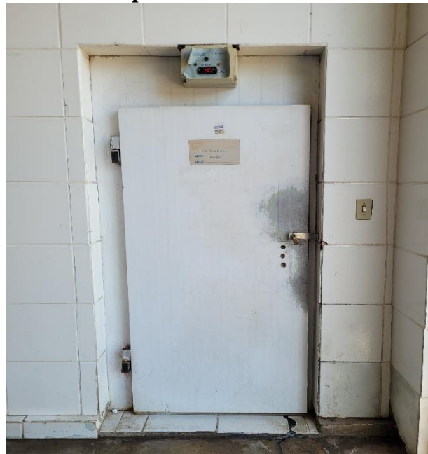
Figura 8 - Equipamento utilizado para o armazenamento de resíduos orgânicos do RU
