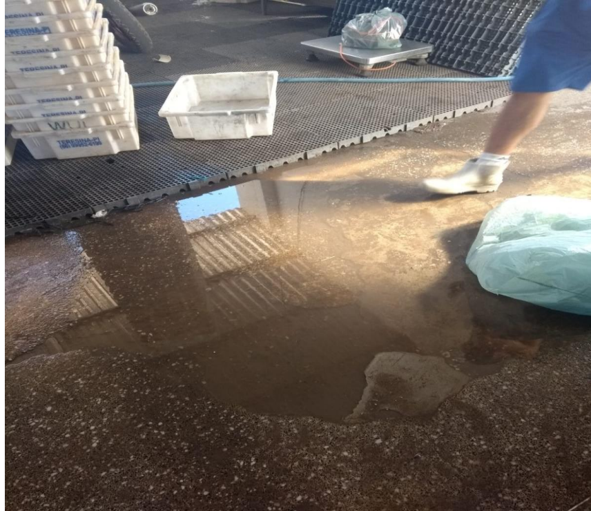
Figura 21. Defeito no piso no setor de atacado do mercado do peixe de Teresina, PI. Fonte: Arquivo pessoal (2021)
