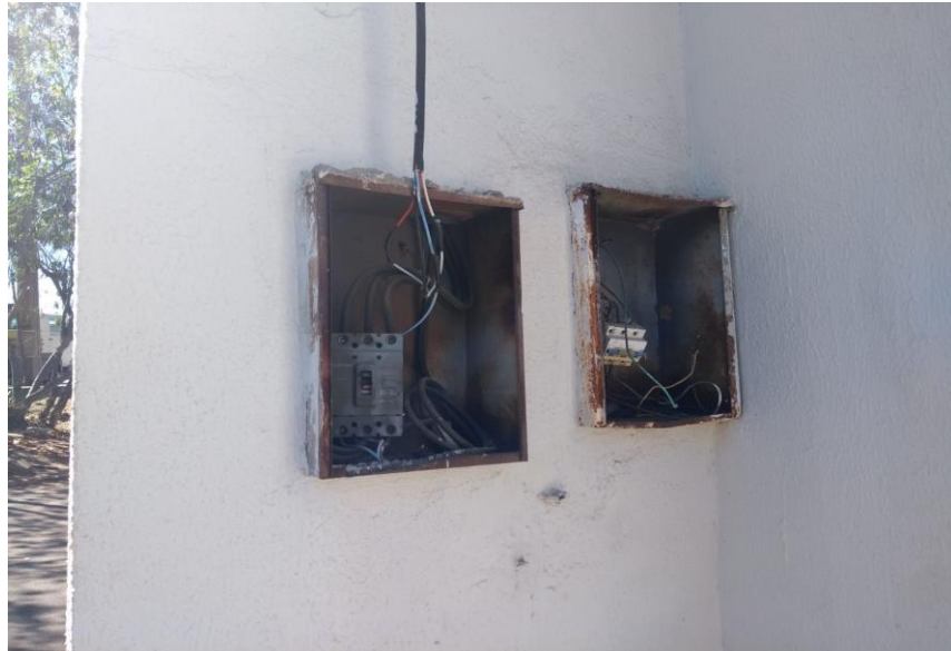
Figura 19. Caixas de energia do mercado do peixe deTeresina, PI. Fonte: Arquivo pessoal (2021)
