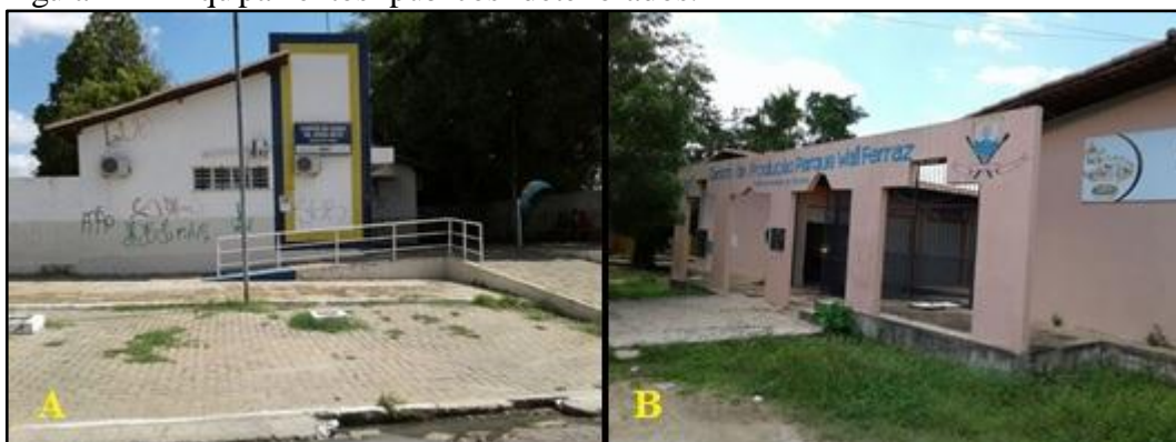
Figura 21 – Equipamentos públicos deteriorados.
