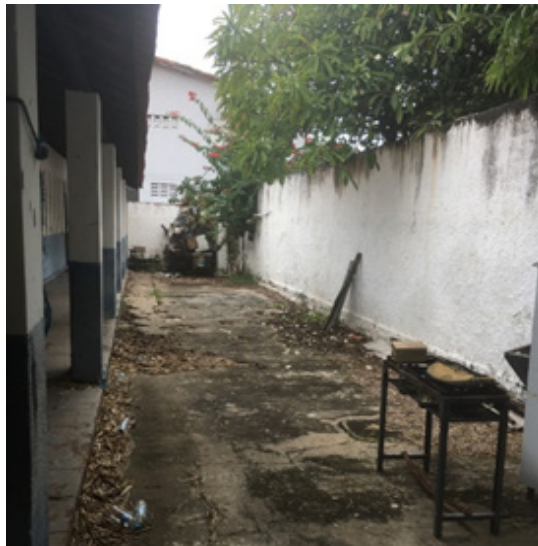
Figura 37 – Vista do Pátio Aberto. Lixo e Sujeira acumulados
