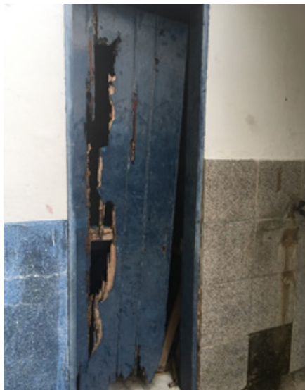
Figura 40 – Porta do depósito em avançado processo de degradação
