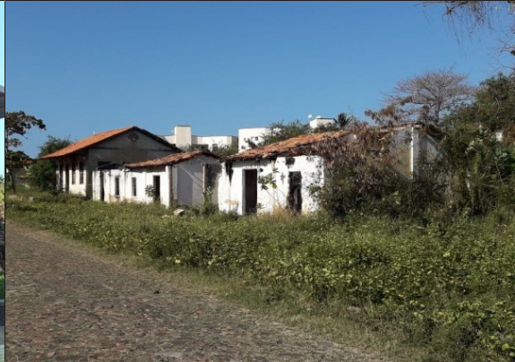
Figura 25 - Edificação em ruínas ao lado do prédio que abriga o Museu do Trem do Piauí. Análise de fatores externos que, ao mesmo tempo, simbolizam oportunidade e ameaça
