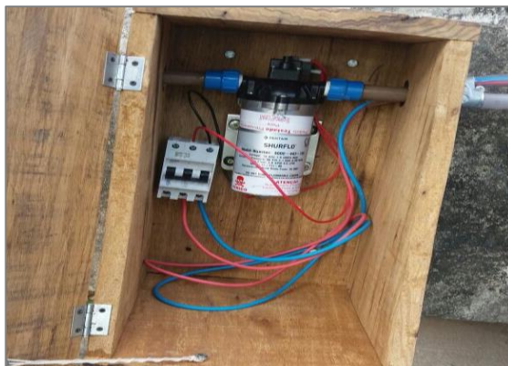
Figura 26 - Bomba utilizada no projeto movida a energia fotovoltaica
