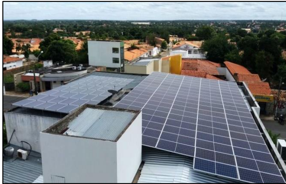
Figura 12 - Módulos sob o telhado de uma indústria no Município de Floriano-PI
