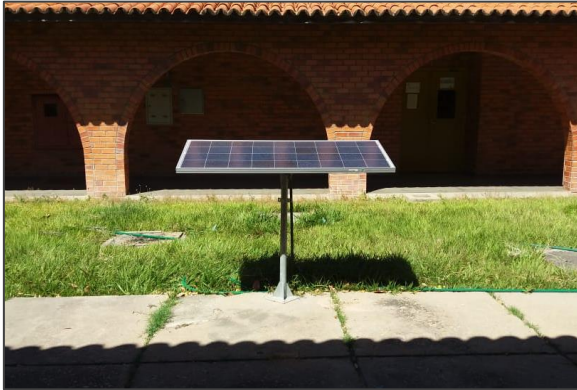
Figura 24 - Módulo fotovoltaico de 95W adquirido pelo projeto
