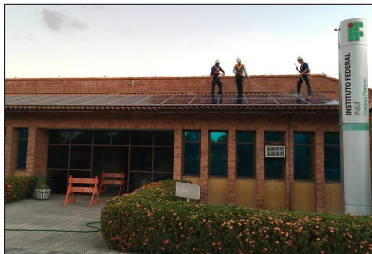
Figura 20 - Limpeza dos módulos feita por funcionários do IFPI Campus Florianiano
