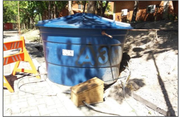
Figura 25 - Armazenamento da água captada e bomba de irrigação
