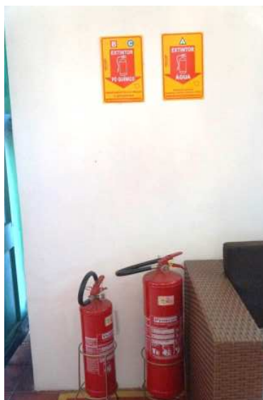
Imagem 41: Imagem de algumas sinalizações que indicam o uso de extintores como normas de segurança no Museu do Piauí. Fonte: Acervo Pessoal da Pesquisadora.
