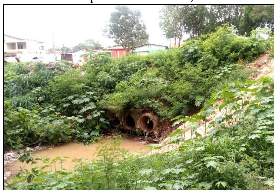
Figura 60 – Ponto de lançamento de esgoto no setor 28 (bairro Ilhotas, na margem esquerda do rio Poti)
