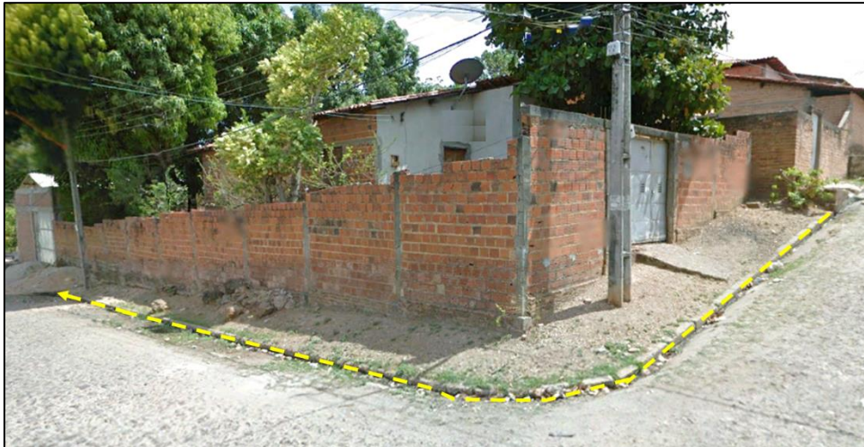
Figura 67 – Esgoto a céu aberto no setor censitário 13 (bairro Água Mineral, região Centro-norte de Teresina) com destaque para o sentido do escoamento
