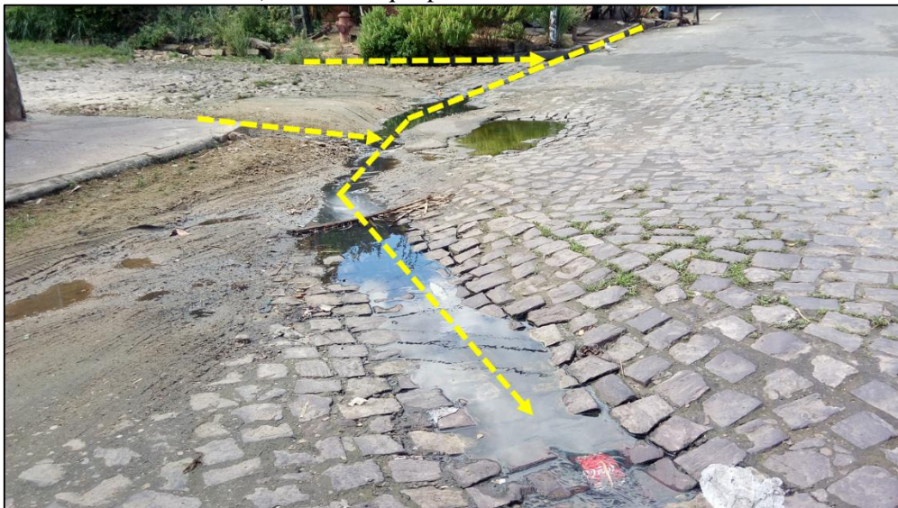
Figura 66 – Esgoto a céu aberto no setor censitário 47 (bairro Fátima, região Leste de Teresina) com destaque para o sentido do escoamento
