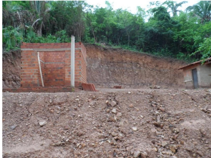
Figura 15. Residência localizada próximo à área de morros no bairro Santa Teresa, Teresina/PI.
