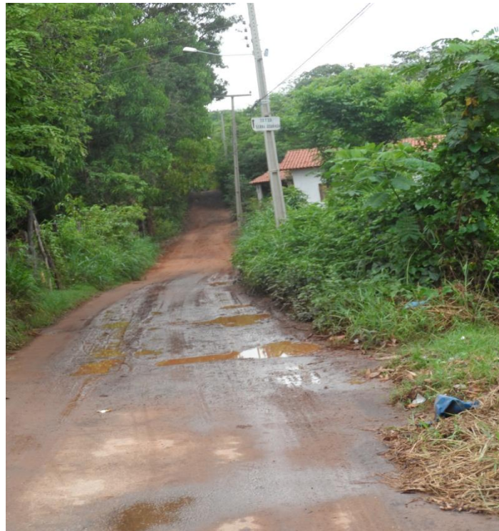
Figura 28. Rua do bairro Santa Teresa, Teresina/PI, com pavimentação precária e ausente.
