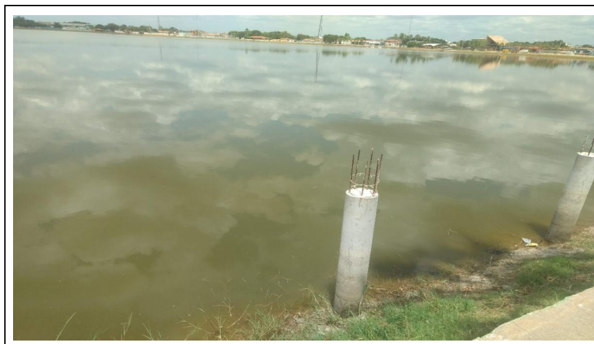
Figura 2 - Obra inacabada nas margens do Açude Grande em Campo Maior/PI.
