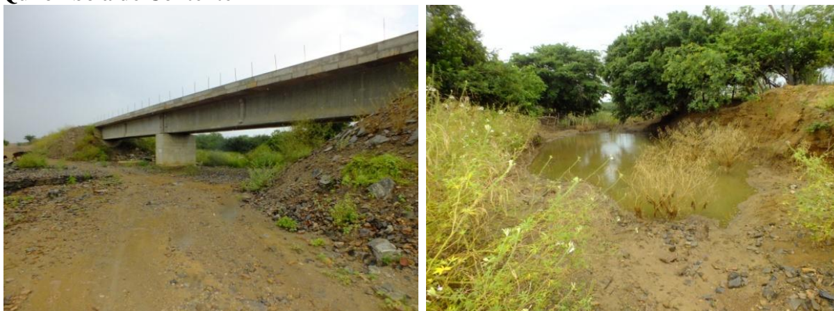
Figura 27 – Fontes de água prejudicadas pela obra da ferrovia na Comunidade Quilombola de Contente
